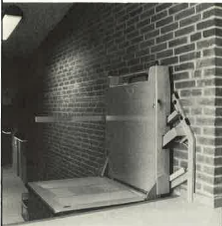
Lift klar til påkørsel - sikkerhedsarmen er slået ned.
